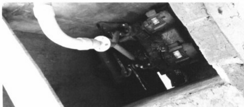
Figura 03 – Bombas da unidade de tratamento
