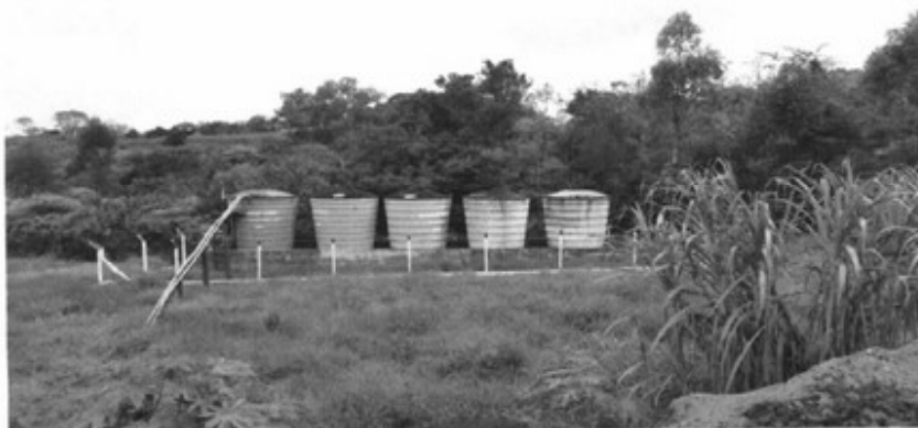
Figura Q – Tanques de contenção de soro de leite.
