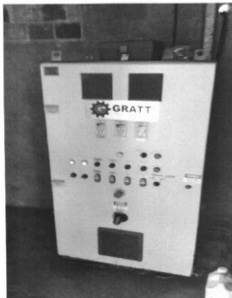
Figura 04 – Quadro de comando
