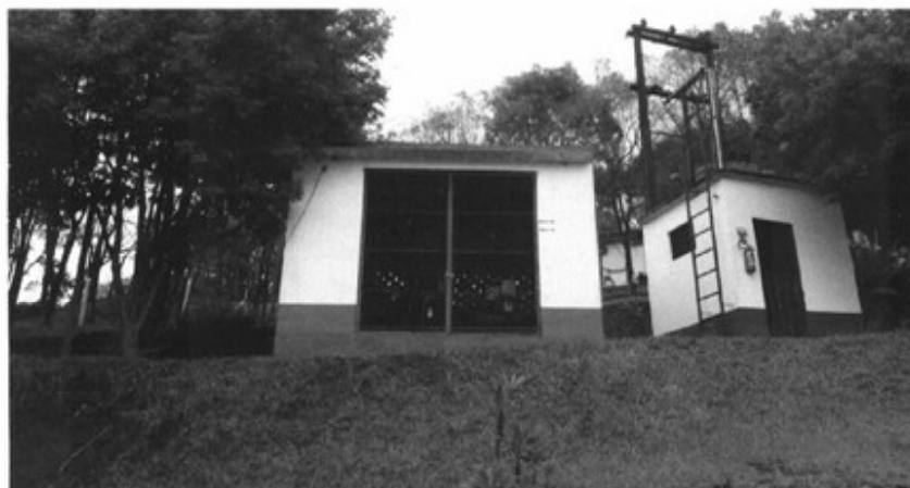
Figura L – Transformador e Grupo Gerador.
