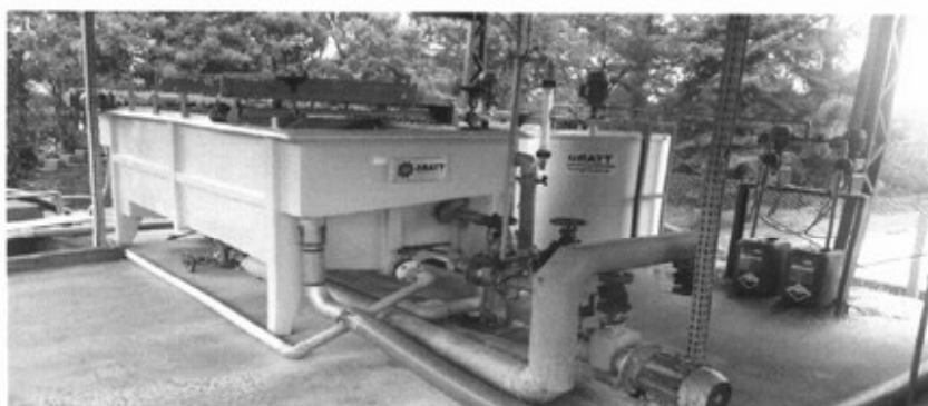
Figura 02 – Flotador Físico Químico
