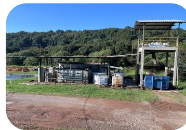
Estação de tratamento de efluentes
